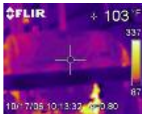
(Después) Filtro- Y Cubierto Fotografía Termográfica
